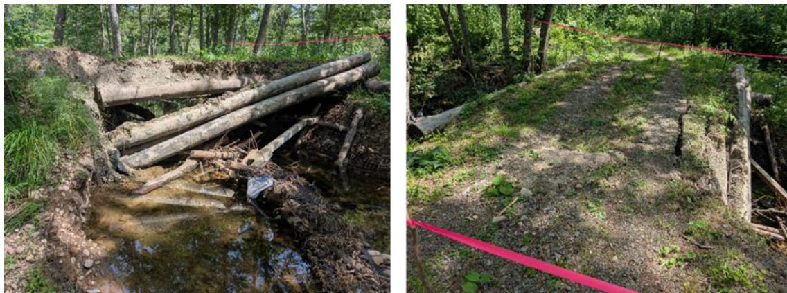
夏季の大雨による橋の崩落の様子
