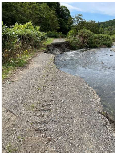
降雨災害による林道崩壊
