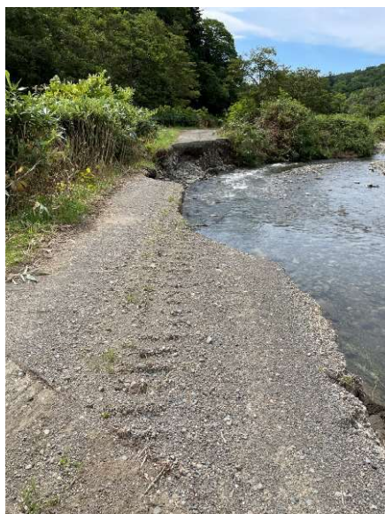
降雨災害による林道崩壊
