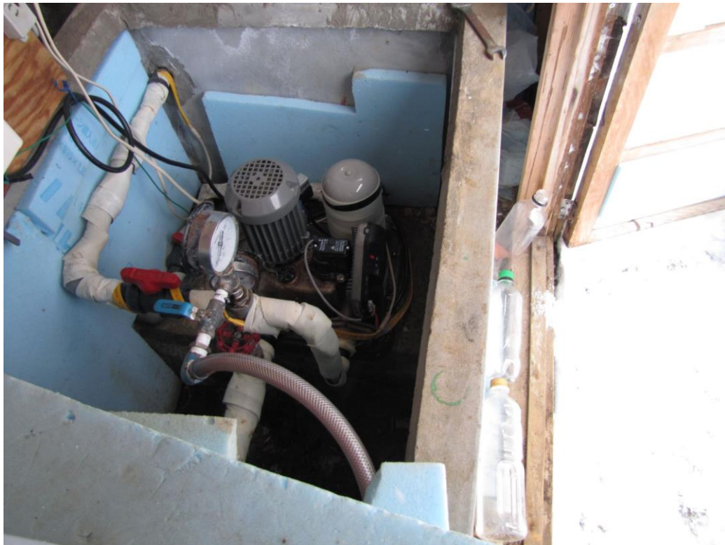
▲忍路臨海実験所本館ポンプ庫内の海水汲み上げポンプ
